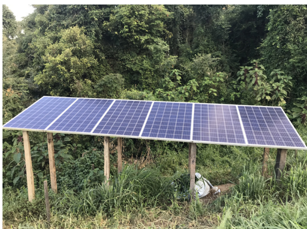
Placas solares para bombeamento de água em sistema off-grid
