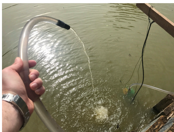
Água sendo bombeada por sistema solar fotovoltaico em dia de pleno sol
