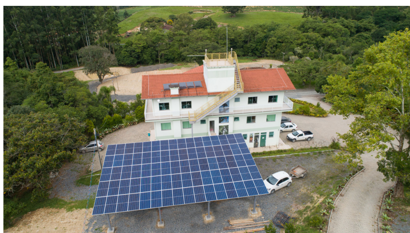
Placas de energia solar ao lado do Centro Ambiental e viveiro da Apremavi. Foto: Wigold Schaffer
