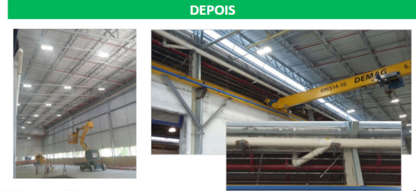
Projeto Expansão Captação Água de chuva
