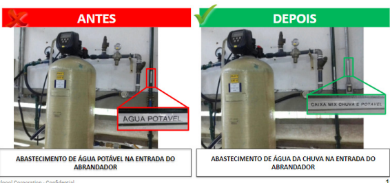
Projeto Expansão Captação Água de chuva
